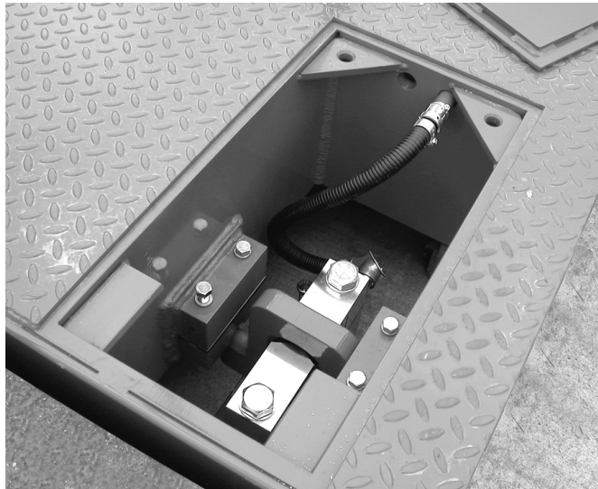
Figura 3-4. Vista Superior del Área de Acceso de las Celdas de Carga
